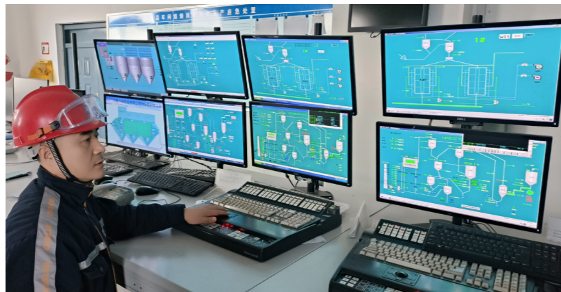
中州铝业 4 号焙烧炉收尘技改项目投入运行，实时记录、动态监控相关碳排放数据
