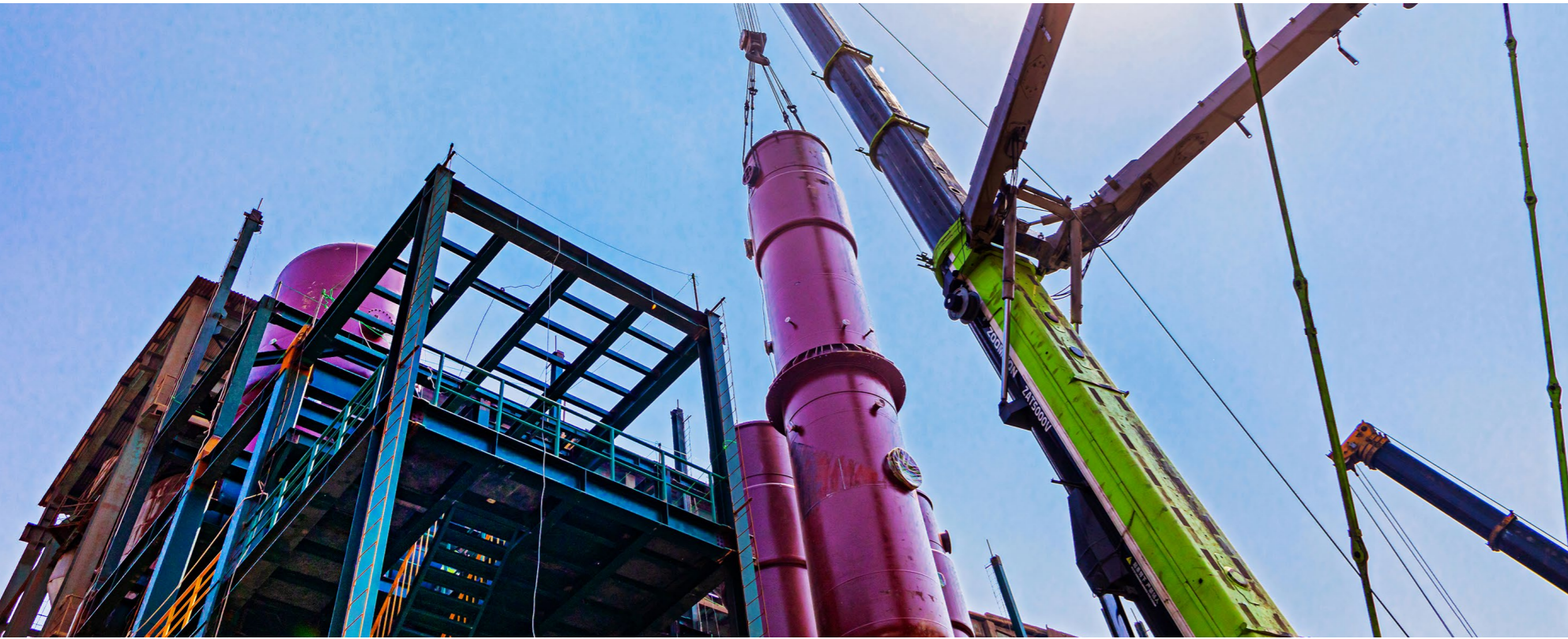
中州铝业精细氧化铝生产线增设新型蒸发器，降低能源消耗。图为蒸发器加热室吊装现场
